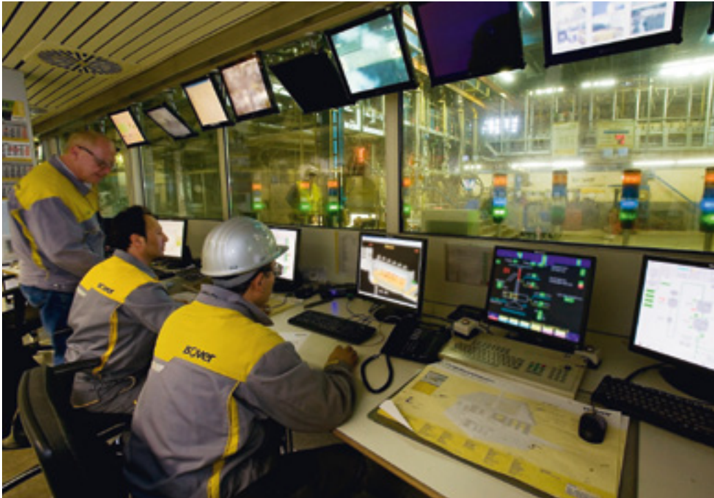
Abb. 11 Leitwarten sind zu Bildschirmarbeitsplätzen geworden und müssen entsprechend gestaltet werden.
